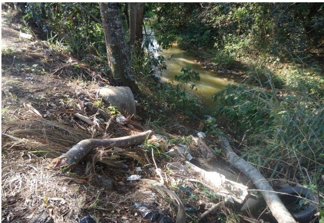
Figura 31 - Saída de água sem dissipador de energia – Ribeirão São José (Ponto O).
