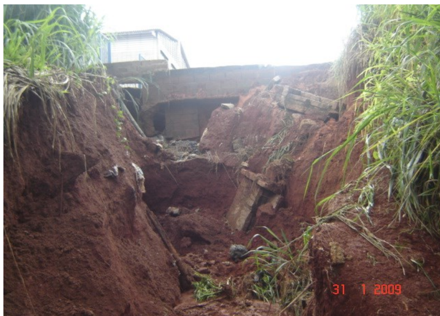
Figura 21 - Erosão na região da estrada Vale das Pedras.
