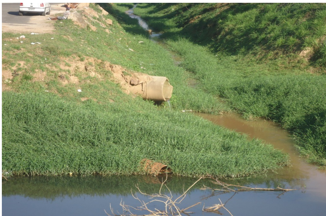
Figura 33 - Saída de água sem dissipador – Córrego da Lagoa (Ponto Q).
