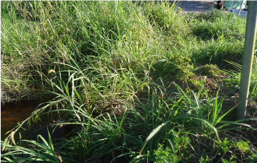
Figura 28 - Boca de lobo encoberta pela vegetação (Ponto N).
