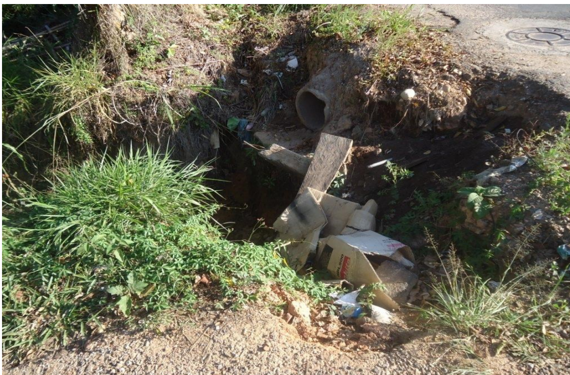
Figura 26 - Boca-de-lobo sem limpeza e manutenção (Ponto L).
