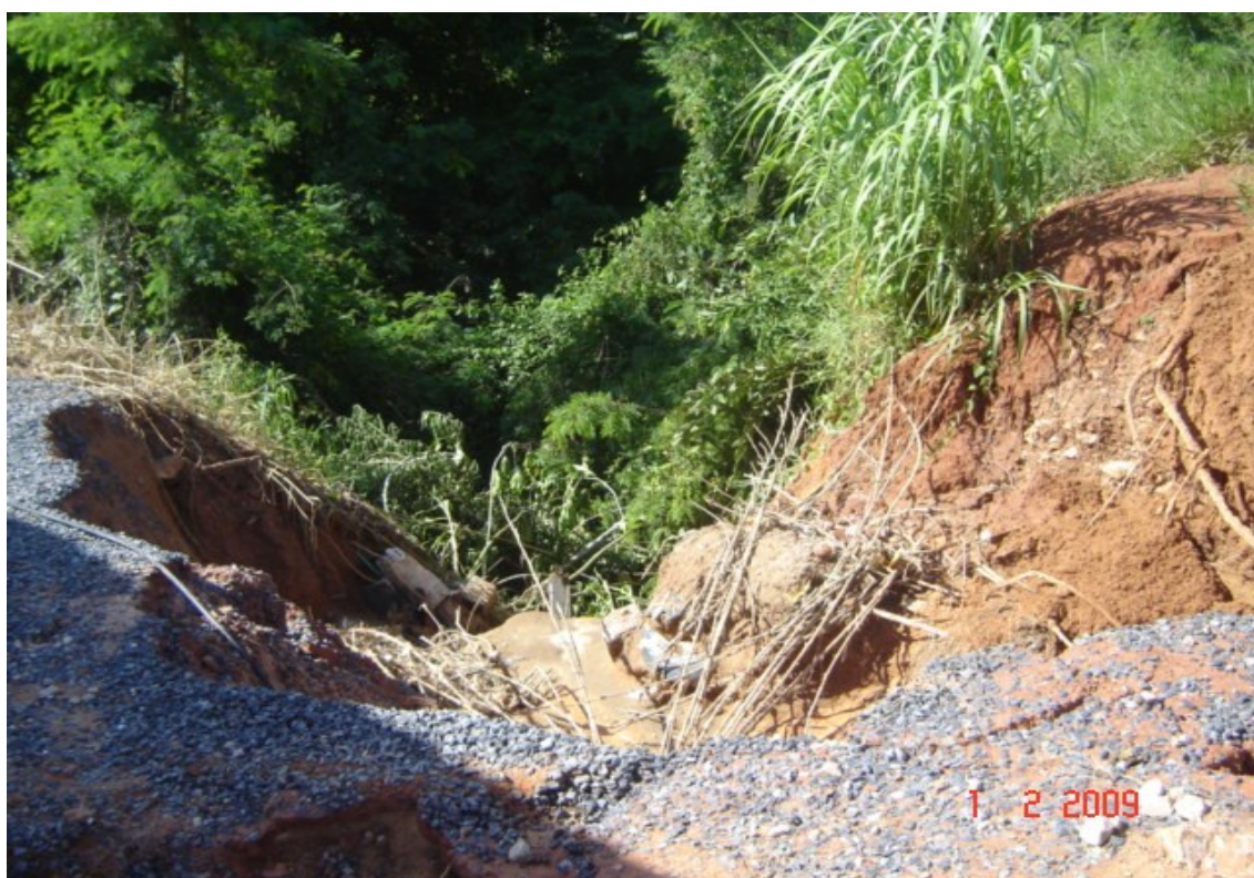
Figura 22 - Erosão na região da estrada Vale das Pedras.
