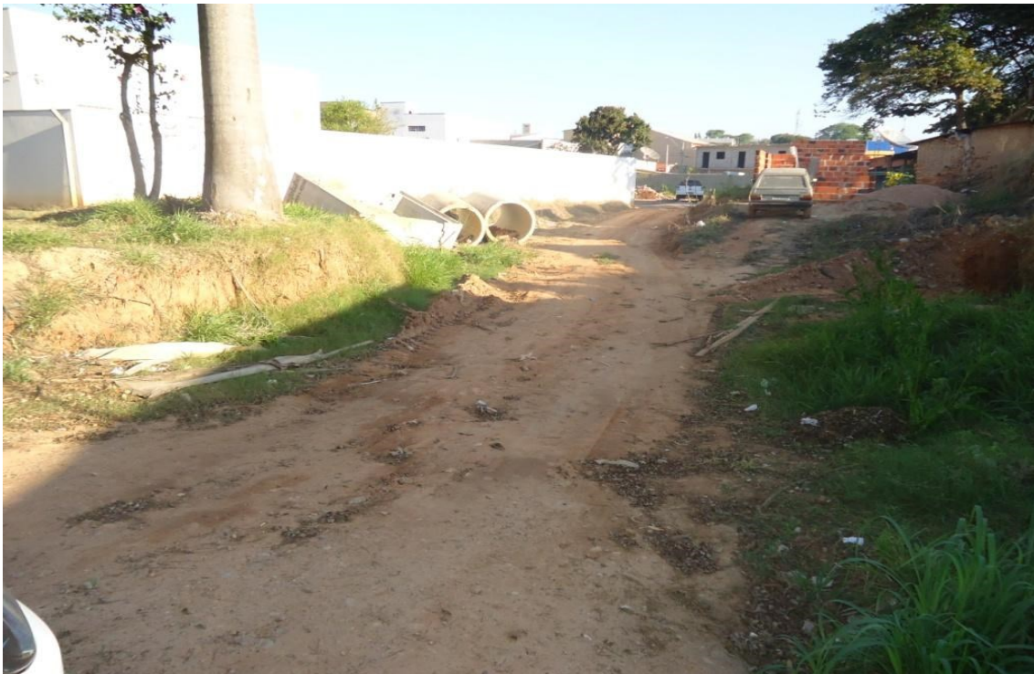
Figura 10 - Ponto alagamento do Córrego do Bonfim canalizado (Ponto E).
