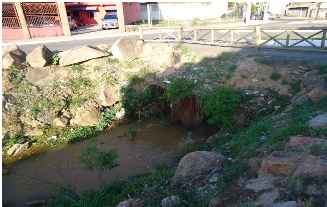
Figura 7 - Ponto de alagamento do Córrego da Lagoa (Ponto B).
