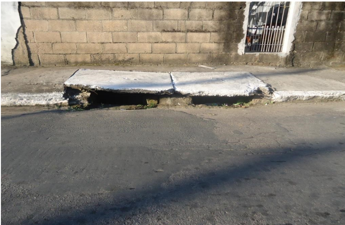
Figura 25 - Boca-de-lobo sem manutenção (Ponto K).
