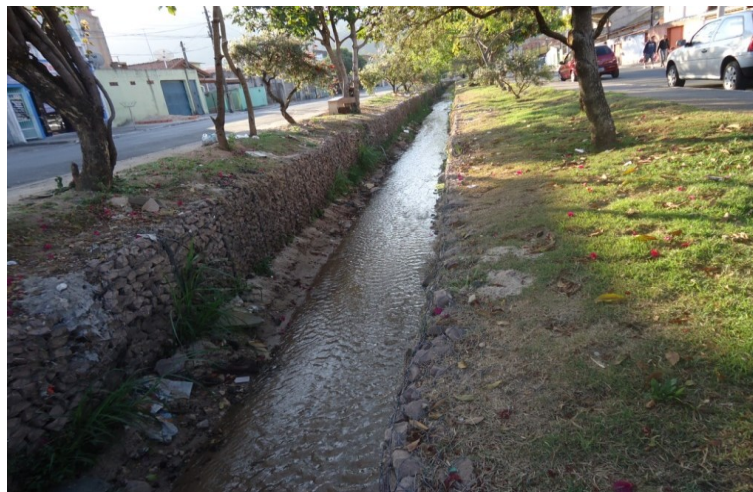
Figura 8 - Ponto de alagamento Rio Piracatu (Ponto C).
