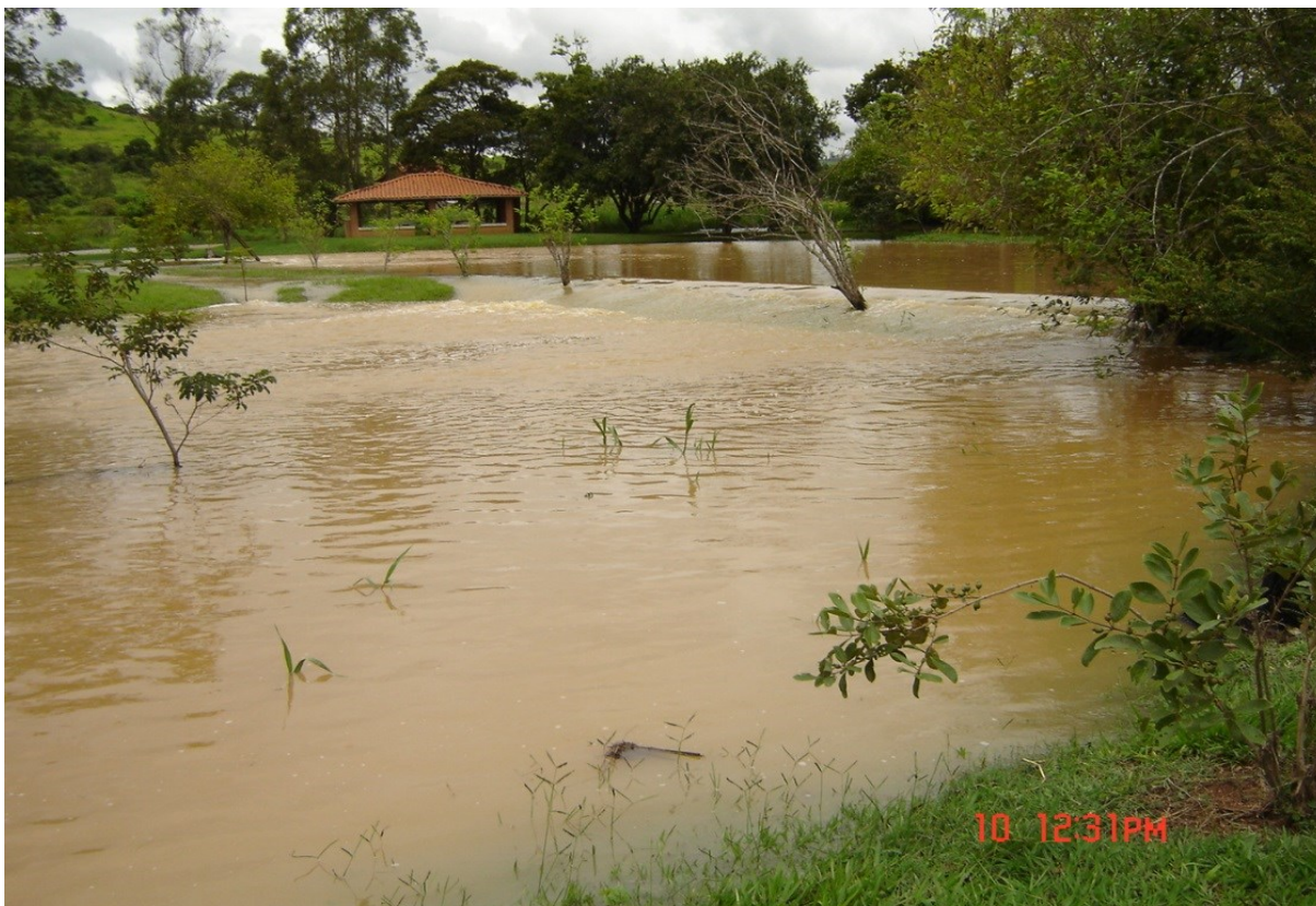
Figura 42 - Extravasamento de barragem no bairro do Guacuri.
