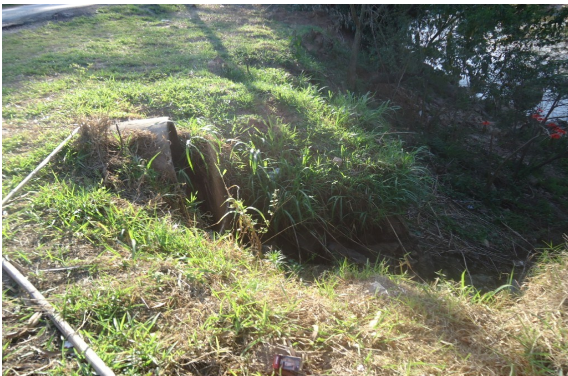
Figura 32 - Erosão causada pela saída de água sem dissipador – Rio Jundiáí (Ponto P).
