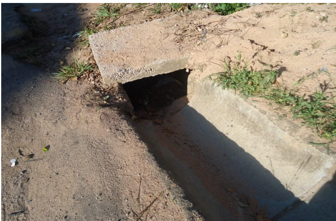
Figura 27 - Boca-de-lobo sem limpeza (Ponto M).
